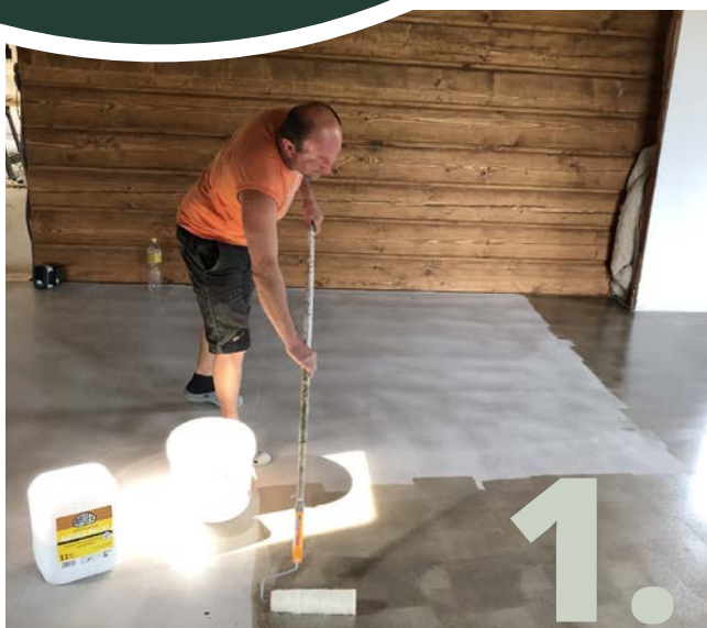
Penetrace zbrošené lité podlahy
